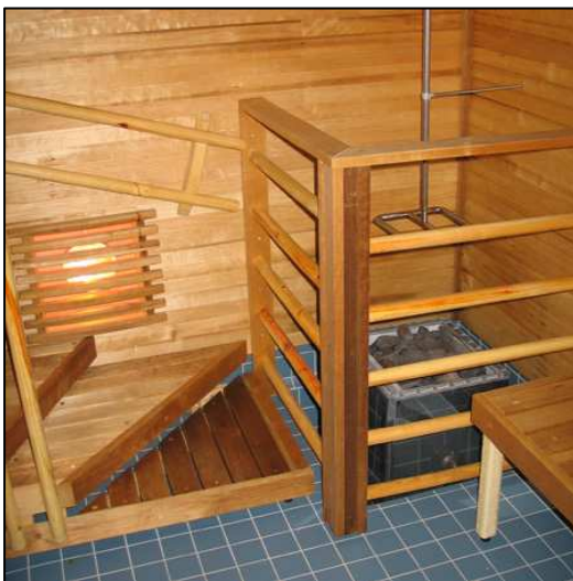
Kuva 12. Kiuassuojakaide ja sadetin. Tampereen ammattikorkeakoulun Itsetilassa, saunaan on laitettu sadetin löylynheittäjäksi. Kiuas on myös suojattu hyvin kaiteilla.
